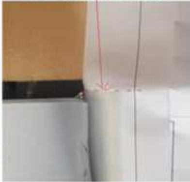
ŹLE - BRAK PRZECIĘCIA
