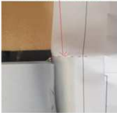
ŹLE - BRAK PRZECIĘCIA
